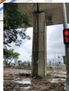
PJ31墩柱水管露出, 水管遭壓破裂、滲水
