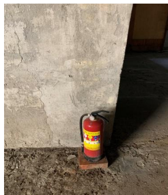
圖7：「豐原火車站臺鐵3號倉庫」滅火器設置
