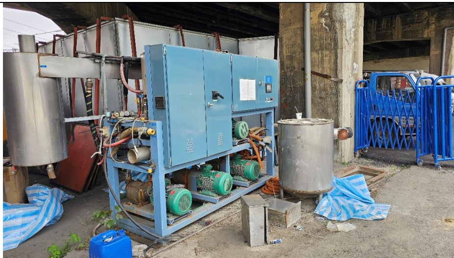
廢洗車機供液裝置 1 台
