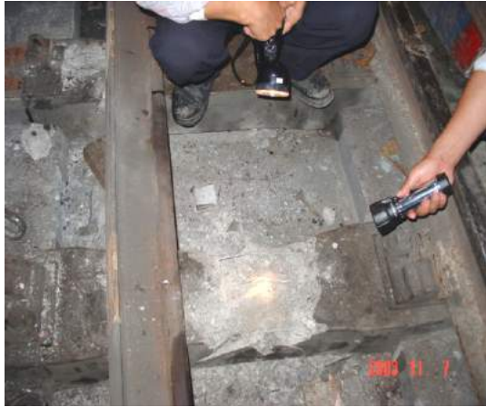
(照片 9-25) 軌道受損情形
