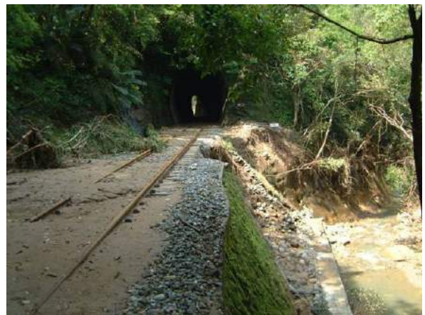
照片 7.1-2 隧道口災害
