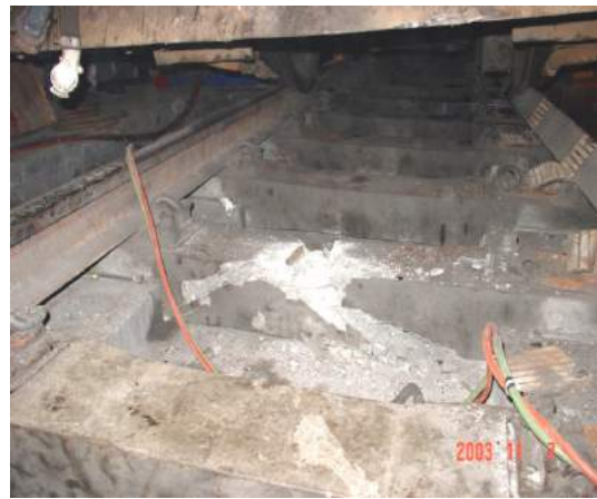
(照片 9-28) 彈性軌枕受損情形
