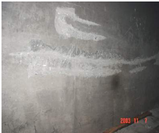
(照片 9-27) 隧道側壁受出軌車輛撞擊痕跡
