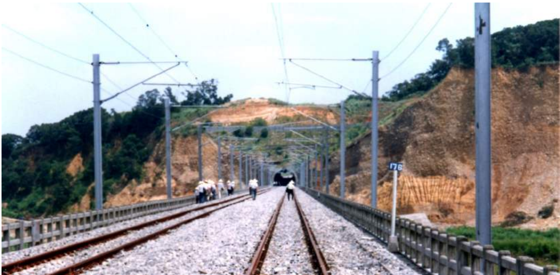
照片 7.1-5 山線大甲溪橋向后豐隧道方向 洞口大片邊坡為卵礫石層 易崩塌
