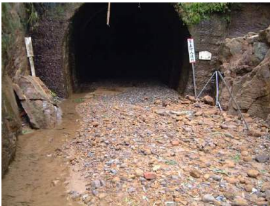
照片 7.1-1 隧道口災害
