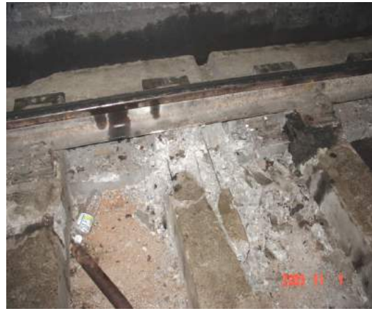
(照片 9-26) 軌道受損情形
