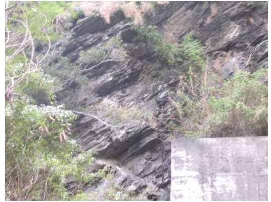
圖 5.6-18 大鳥隧道北洞口上邊坡砂岩層露頭
